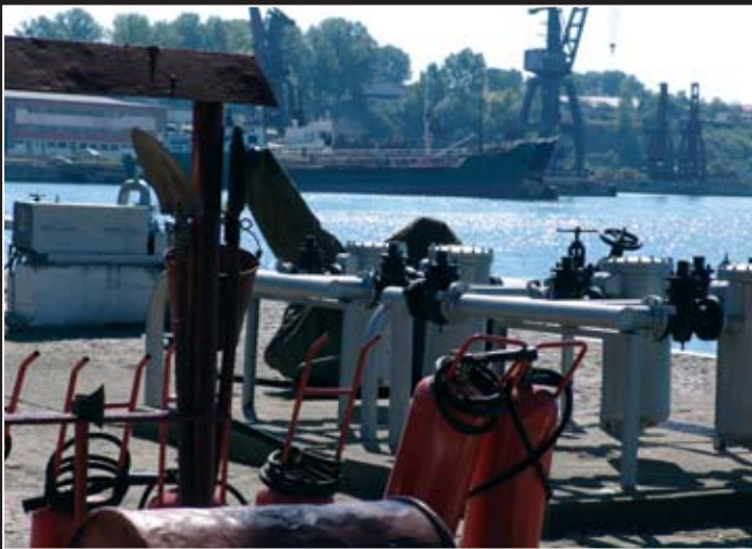
Instalația de transfer a combustibilului de la tancul maritim spre rezervoare, din cadrul Depozitului 305 Mixt.
