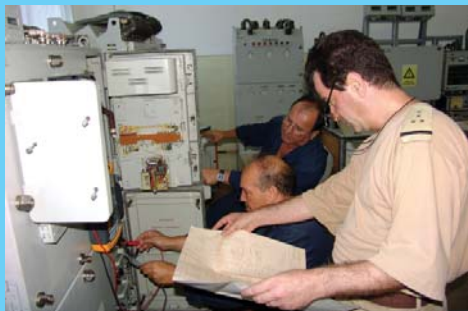
Secția I. Mm.I Daniel Frangu, Pcc Vasile Constantin și Pcc Nicu Șarpe execută mentenanță de complexitate ridicată la blocul emițător-receptor al stației de radiolocație GARPUN.
